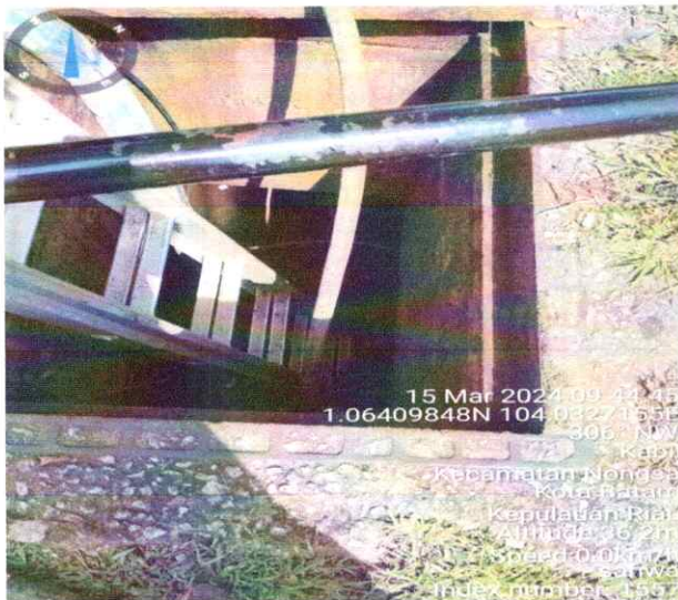
buka tutup mainhole
