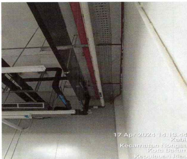
jalur kabel di gedung
