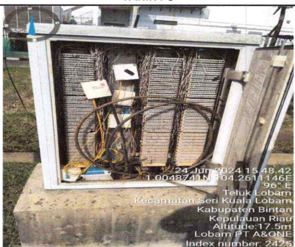
TERMINASI DI ODC
