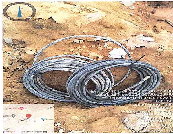
PERTEMUAN KABEL DI CLOSURE
